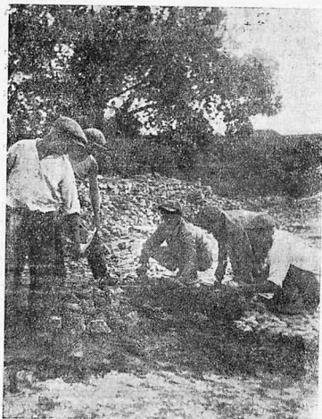
Готовят дороги для перевозки урожая. На снимке — укладка шоссе в Плавском районе, Московской области
