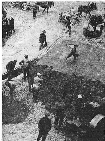
Дорожные работы в Красной столице развернулись огромными темпами. План работ в основном уже выполнен, но работы продолжаютя по встречному плану. На снимке — асфальтировка Самотечной площади. Фото Леонова
